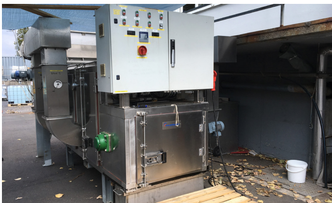
Módulo de descarga con contenedor móvil para el material seco y gabinete de control
