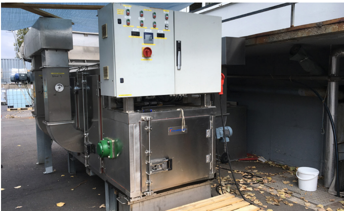
Austragsmodul mit mobiler Aufwängwanne und Schaltschrank oberhalb
