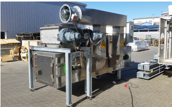
Aufgabetrichter und die Rollenpresse oberhalb des Aufgabemoduls, rechts Abluftkanäle und Abluftgebläse
