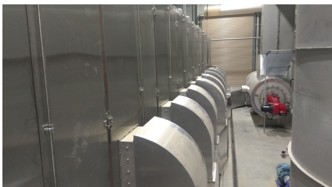
Brenner (rot) mit Brennkammer und anschließendem Zuluftgebläse für den Transport des Heißgases in den Bandrockner
