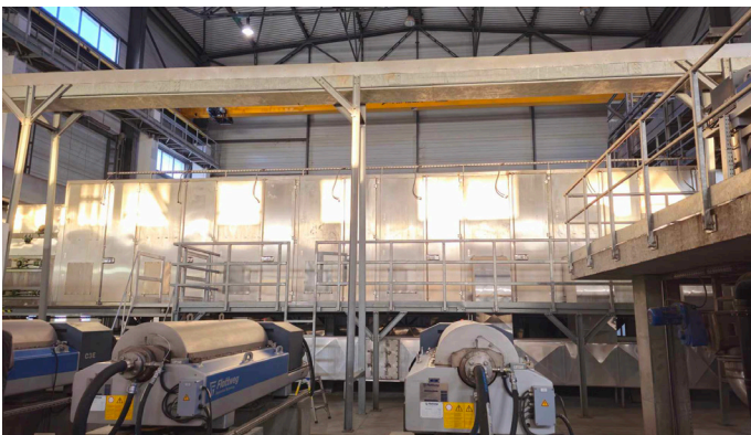
Entwässerungszentrifugen seitlich des Bandrockners
