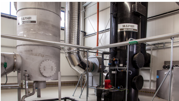
Nasswasser und Saurer Wäscher für Abluft
