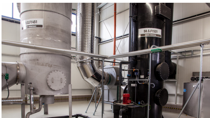
Nasswasser und Saurer Wäscher für Abluft
