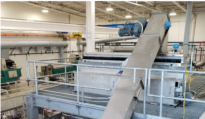
Kettenförderer (Nassprodukt) zur Aufgabeeinheit (Verteiler-/Dosierer)
