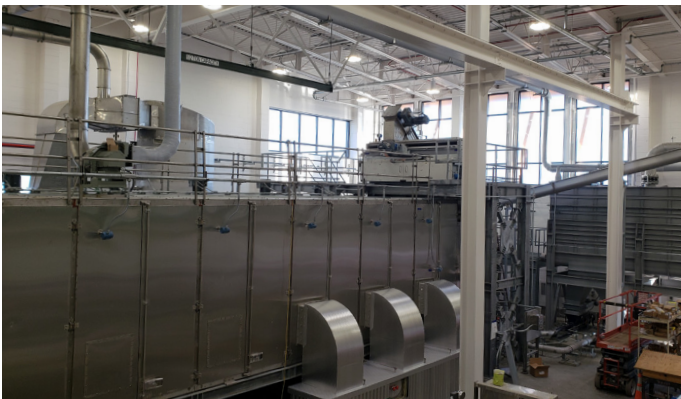
Bandrockner BD 3000/6 mit Abluftkanal, Aufgabeeinheit und Vorlagebehälter
