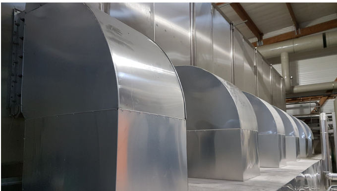
Bandrockner BD 3000/7 mit Abluftkanälen
