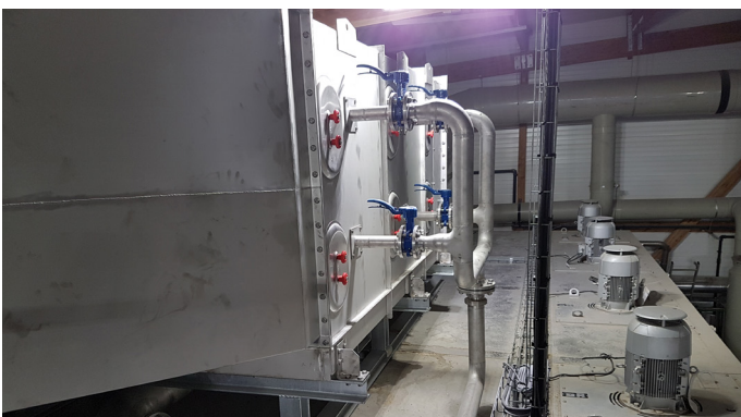
Umluftgebläse und Kondensation
