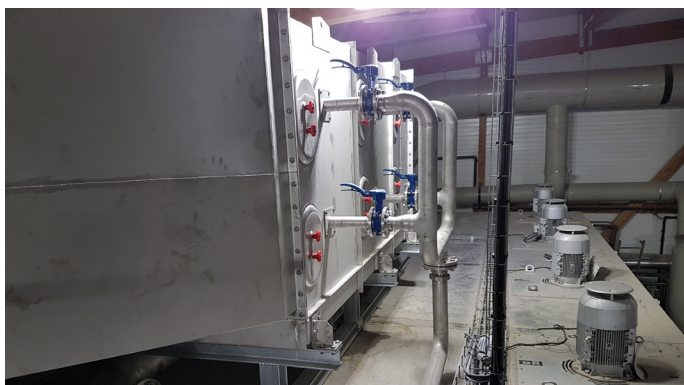
Umluftgebläse und Kondensation
