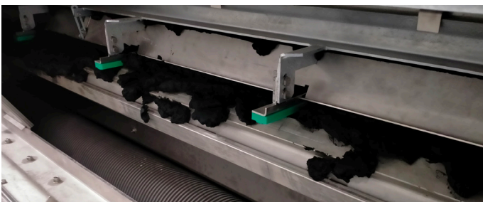
Dosierung rückgemischter Klärschlamm oberhalb der Rollenpresse
