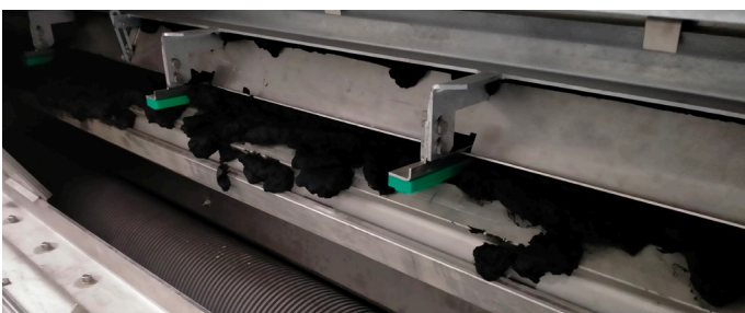
Dosierung rückgemischter Klärschlamm oberhalb der Rollenpresse
