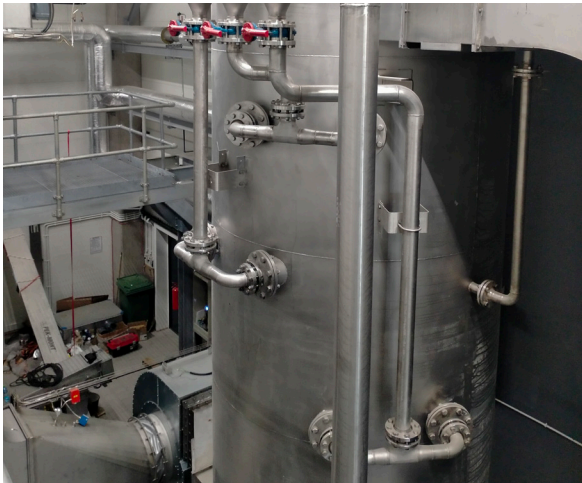
Vorwärmung des Faulschlammes in Gegenstromkolonne mit feuchter warmer Abluft des Trockners
