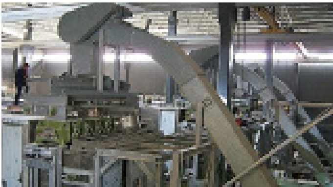
Trogkettenförderer für entwässerten Klärschlamm zur Aufgabeeinheit (3x)
