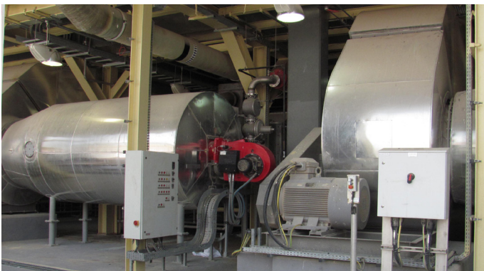
Brenner (rot) mit Brennkammer und Zuluftgebläse
