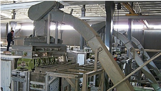
Trogkettenförderer für entwässerten Klärschlamm zur Aufgabeeinheit (3x)
