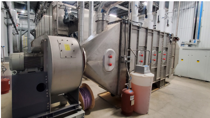
Zuluftgebläse mit horizontalem Kondensator mit Wärmetauscher
