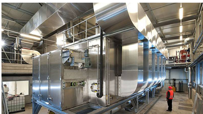
Bandrockner BD 3000/6 mit Umlenkammer und Abluftkanälen
