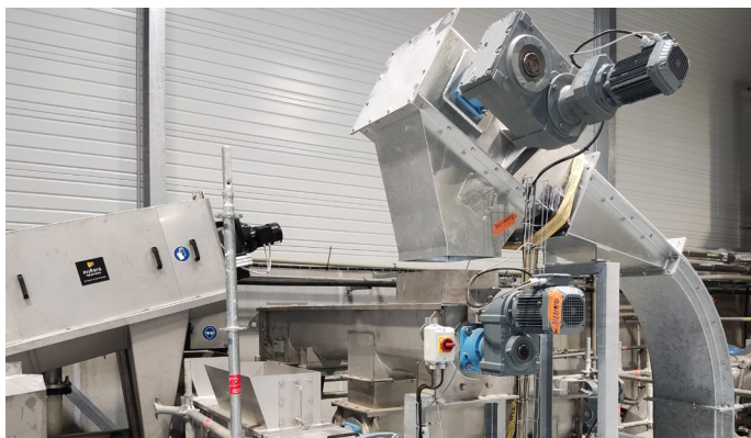
Remezclado: el transportador de cadena en artesa transporta los lodos secos al tornillo dosificador
