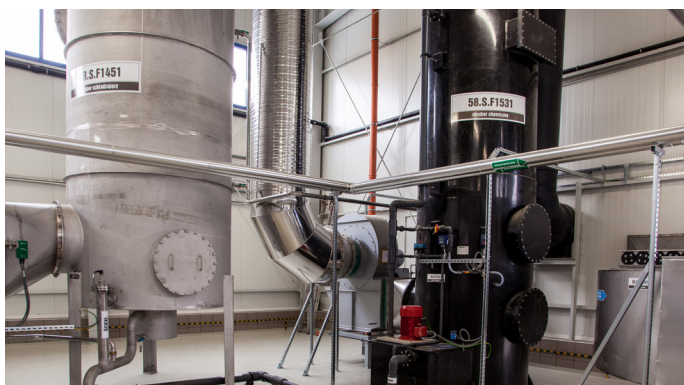
Lavador de agua húmeda y ácido para el aire de salida
