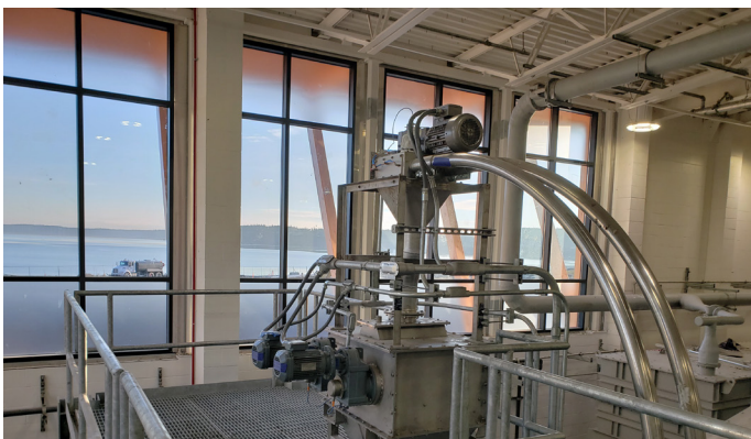
Transportador de cadena de tubos (producto seco) a la trituradora de producto
