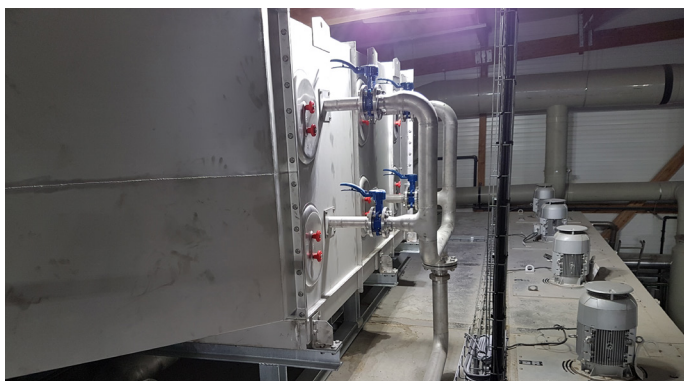
Ventilador de recirculación y condensación
