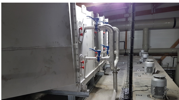
Ventilador de recirculación y condensación
