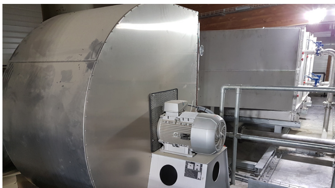
Ventilador de extracción
