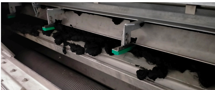
Dosificación de lodos de depuradora retromezclados en una prensa de rodillos
