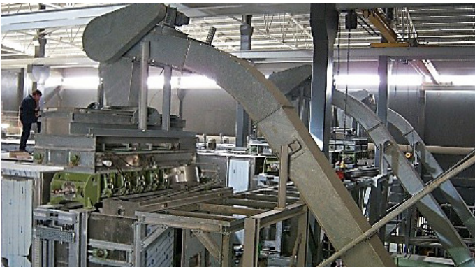
Transportador de cadena de artesa para lodos de depuradora deshidratados a la unidad de alimentación (3x)
