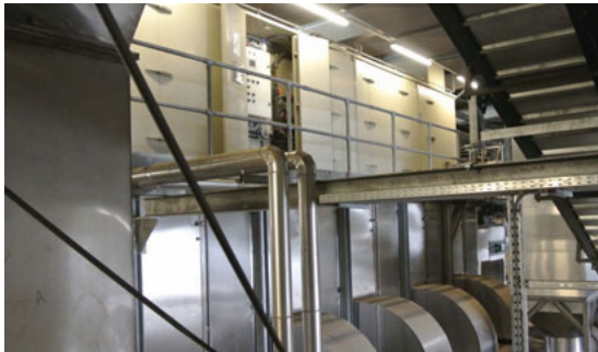
Cámaras 1-3 de la secadora de bandas BD 3000/5 con depurador químico instalado horizontalmente
