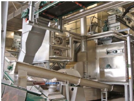
Cámara de entrada y salida con tornillo de descarga
