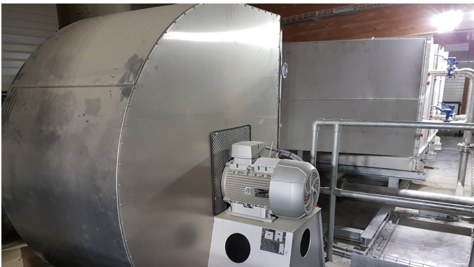
Exhaust air fan
