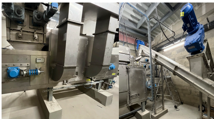
À gauche: Sécheur pilote avec unité d'alimentation et conduits d'évacuation d'air
