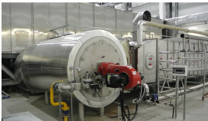
Chambre de combustion avec brûleur pour gaz naturel et ventilateur pour l'air de combustion
