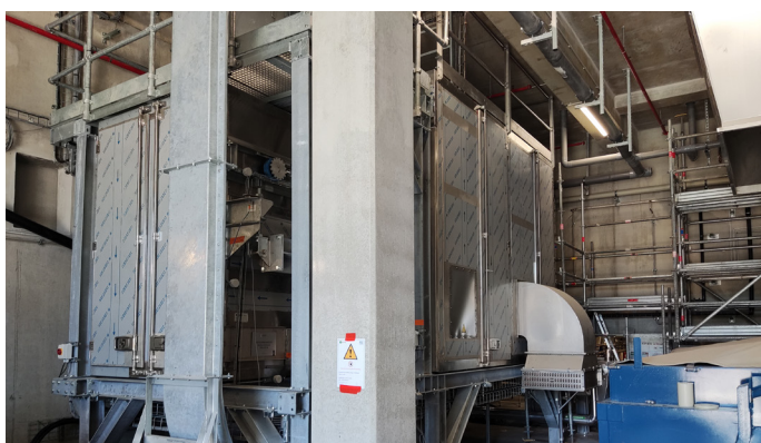
Sécheur à bande BD 1500/2 dans le bâtiment
