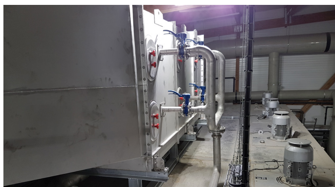
Ventilateur de circulation d'air et condensation
