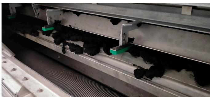
Dosage de boues d'épuration remélangées sur presse à rouleaux
