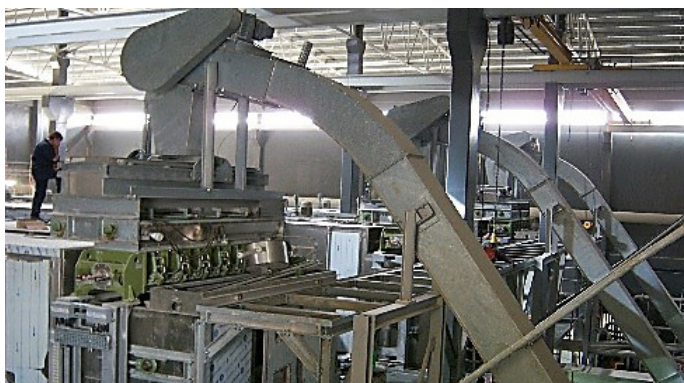
Convoyeur à chaîne pour boues d'épuration déshydratées vers l'unité d'alimentation (3x)
