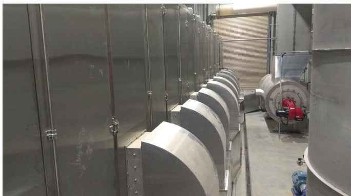
Brûleur (rouge) avec chambre de combustion suivie d'un ventilateur d'alimentation en air pour le transport du gaz chaud dans le sécheur à bande
