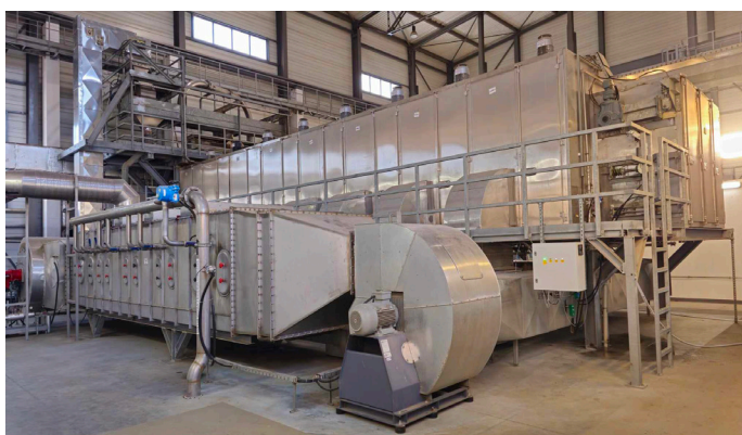
Sécheur à bande BD 3000/8 avec condenseur horizontal direct et ventilateur d'extraction
