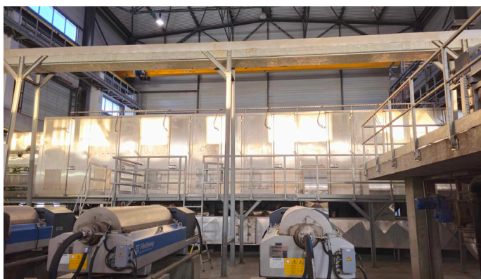
Centrifugeuses de déshydratation sur le côté du sécheur à bande
