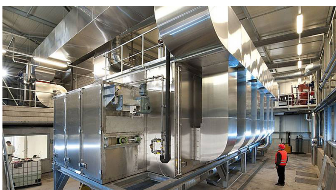
Sécheur à bandes BD 3000/6 avec module de retournement du produit et gaines de sortie d'air.
